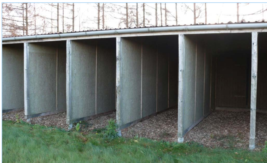
Figur 6. Skydehuset på 100/300 meter banen med 5 meter overdækkede lydsluger. Væggene og loftet er forsynet med lydabsorberende mineraluld, der har afgørende betydning for den ekstra støjdæmpende effekt. Hanebjerg Skyttecenter, december 2009.
